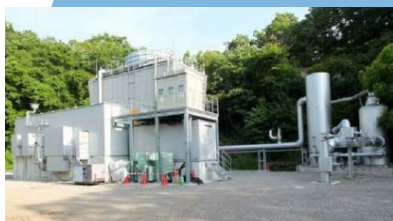
地熱発電所 (地域住民による合同会社が運営)
