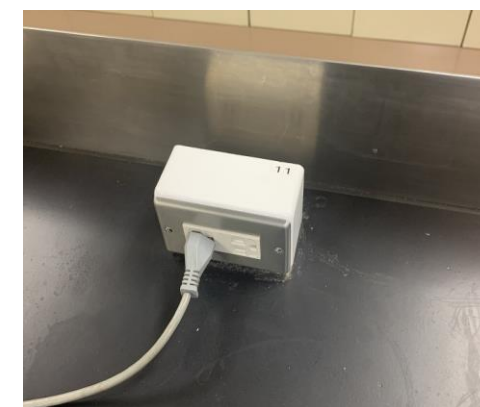
例(3) コンセント点検
