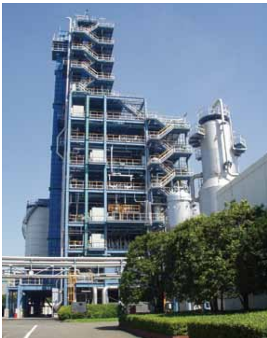
使用済みプラスチックを熱で分解し、化学製品の原料となるガスを作る設備
