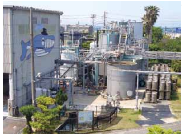
使用済みの酸・アルカリなどを工業製品の原料にリサイクルする設備
