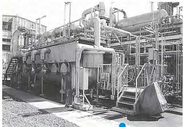
亜酸化窒素除去設備
