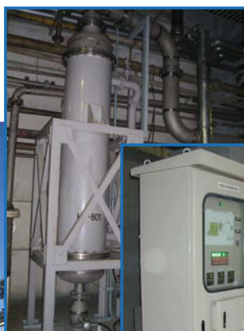
圧縮冷却 回収装置
