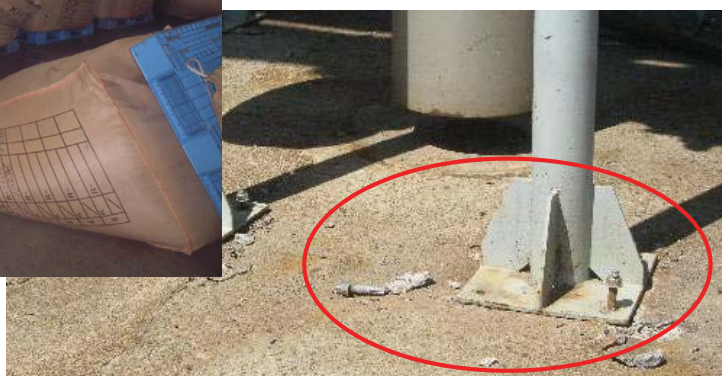
アンカーボルト抜け
