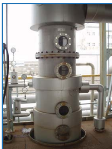
活性炭吸着 回収装置
