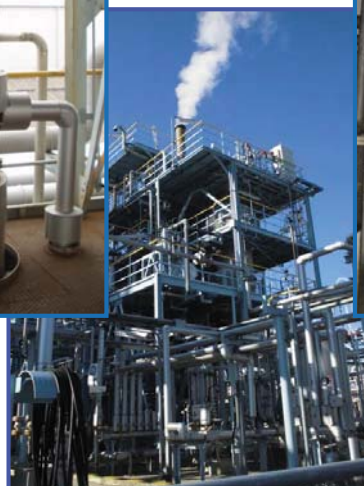
燃焼除去装置
