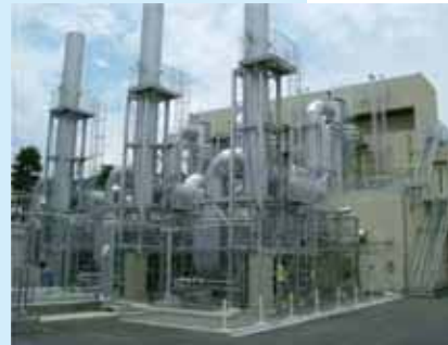
ガスエンジン・コジェネレーション設備
