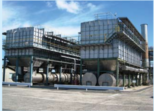
排ガス処理設備
