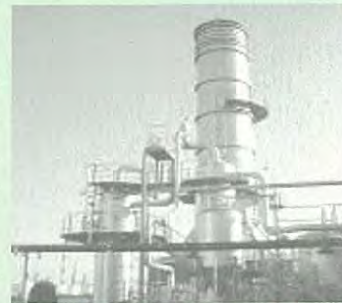
▲化学物質排出削減設備
