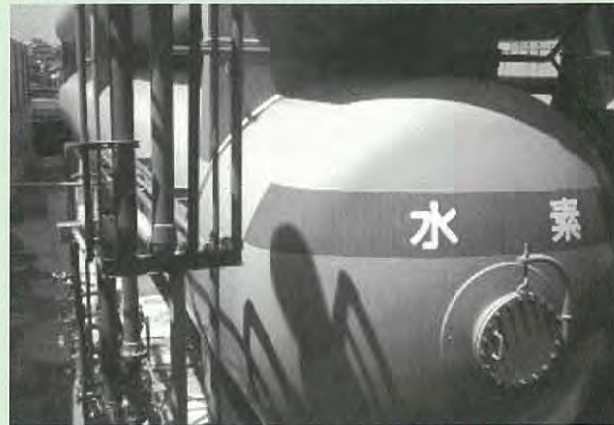
▲クリーンエネルギーの有効利用（水素貯槽）
