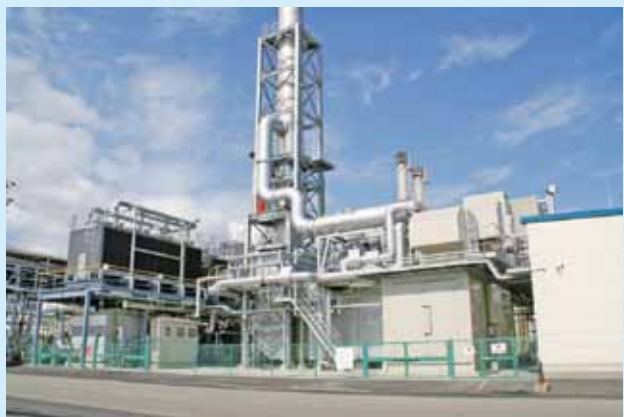
天然ガス(都市ガス)コージェネレーション
