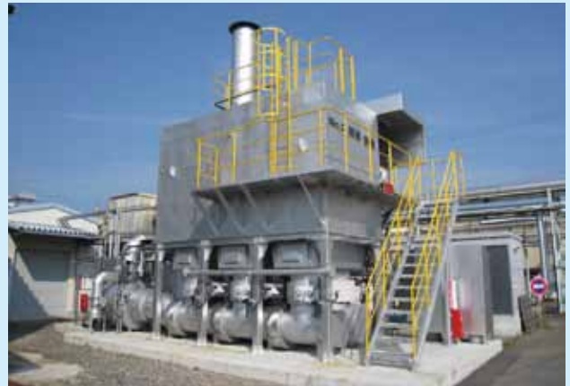
排ガス燃焼装置
