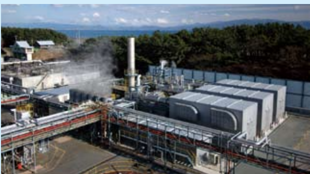
コジェネレーション設備
