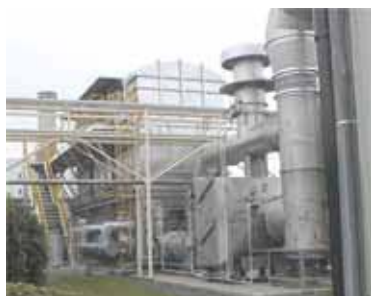
蓄熱燃焼式排ガス処理装置
