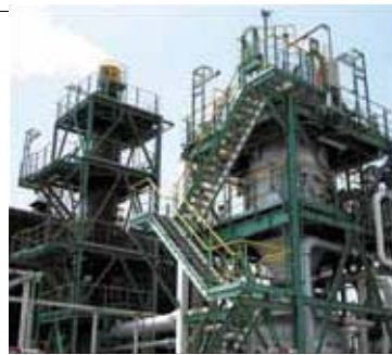
1,000t / 年の能力がある業界屈指のフロン破壊設備
