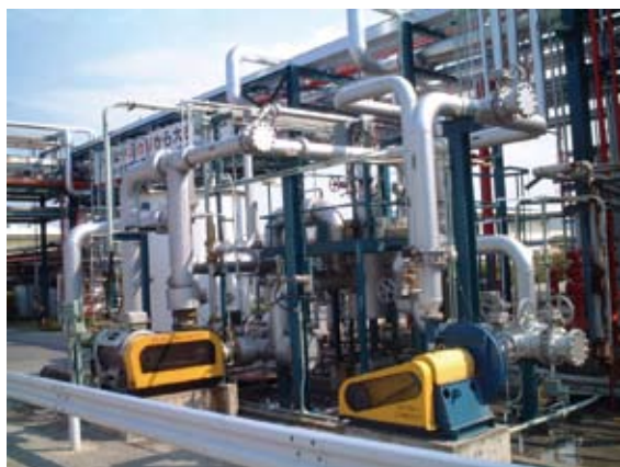
ブタジエンの排ガス燃焼設備
