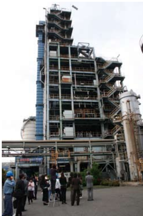
昭和電工(株)川崎製造所のプラスチックゴミリサイクルプラント
