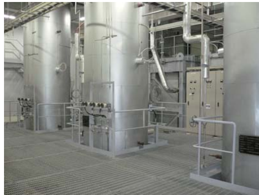
PCB 廃棄物処理施設 (日本環境安全事業(株)東京事業所)
