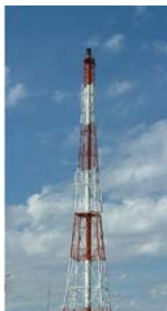
プラントの排ガスをフレアスタックで焼却処理
