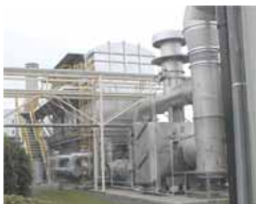
Regenerative thermal oxidizer (RTO)
